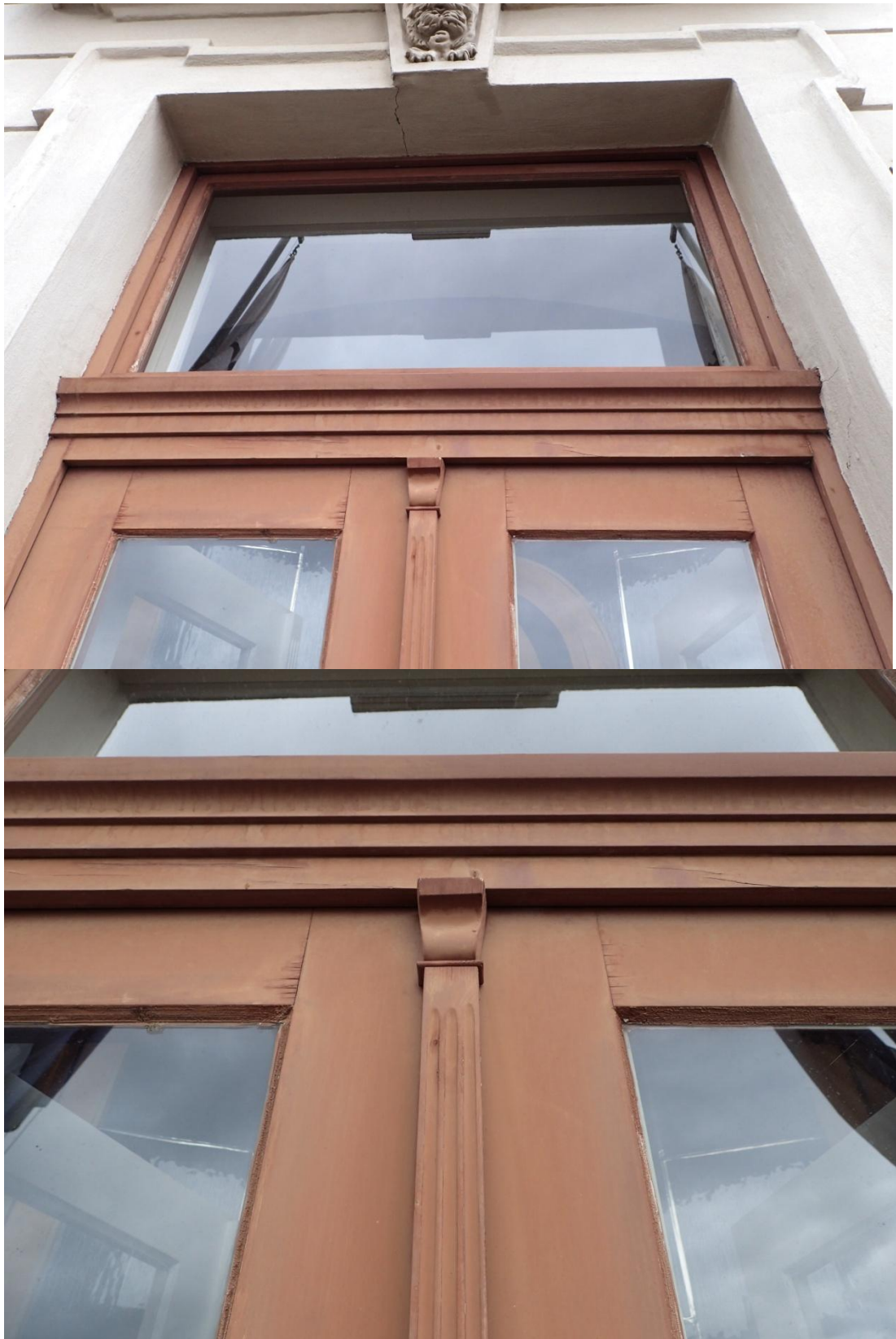
Obr. č. 6+7 Stav při průzkumu – dveře 2. NP – vnější strana – detail – horní část Konstrukčně jsou dveře v pořádku, povrchová úprava je dožilá. Barevný krycí nátěr se hlavně ve spodní části uvolňuje a odpadá. Ve spojích je barva popraskaná. Dobře patrný je poutec a příklopná lišta s hlavicí.
