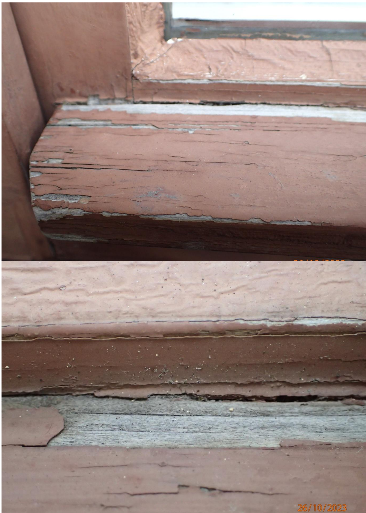
Obr. č. 14+15 Stav při průzkumu – okno 3. NP – vnější strana – detail Konstrukčně je okno v pořádku, povrchová úprava je dožilá. Barevný krycí nátěr se hlavně ve spodní části uvolňuje a odpadá.
