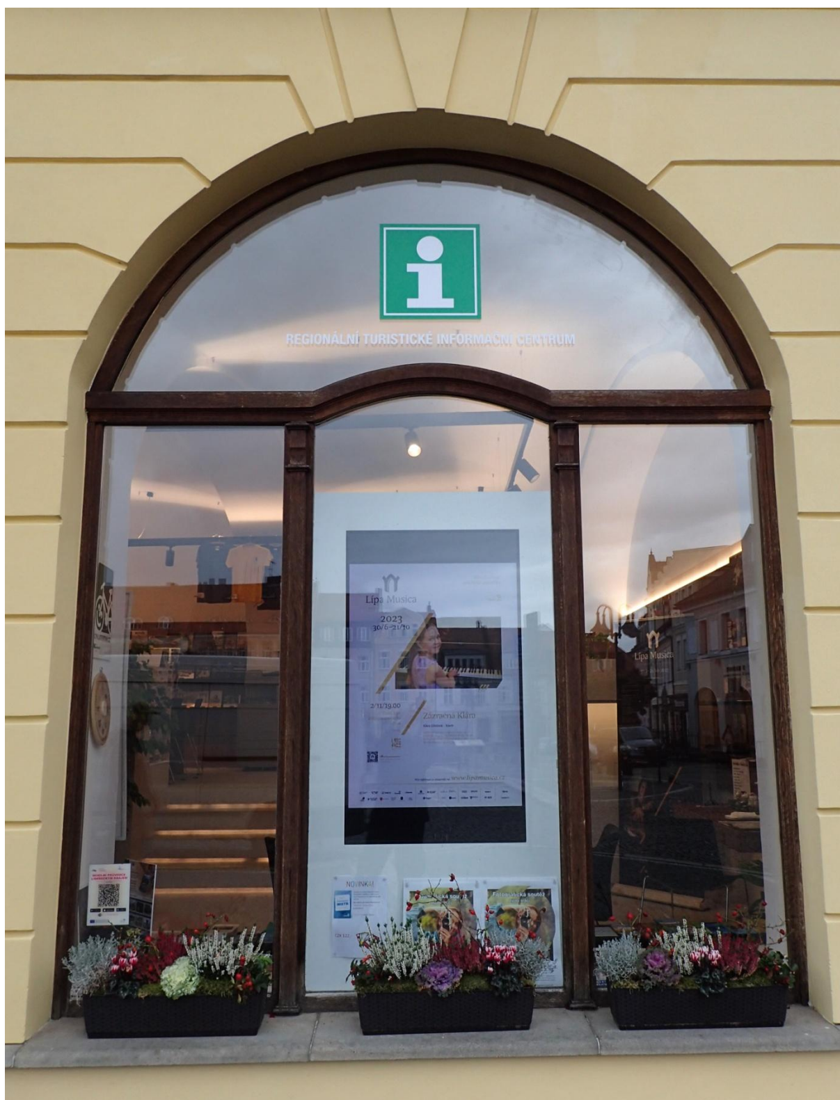
Obr. č. 18 Stav při průzkumu – okno 1. NP – vnější strana – celkový pohled Konstrukčně je okno v pořádku, povrchová úprava je dožilá. Barevná lazura se hlavně ve spodní části uvolňuje a odpadá. Poutec je jednoduše profilovaný. Zasklení je pevné.
