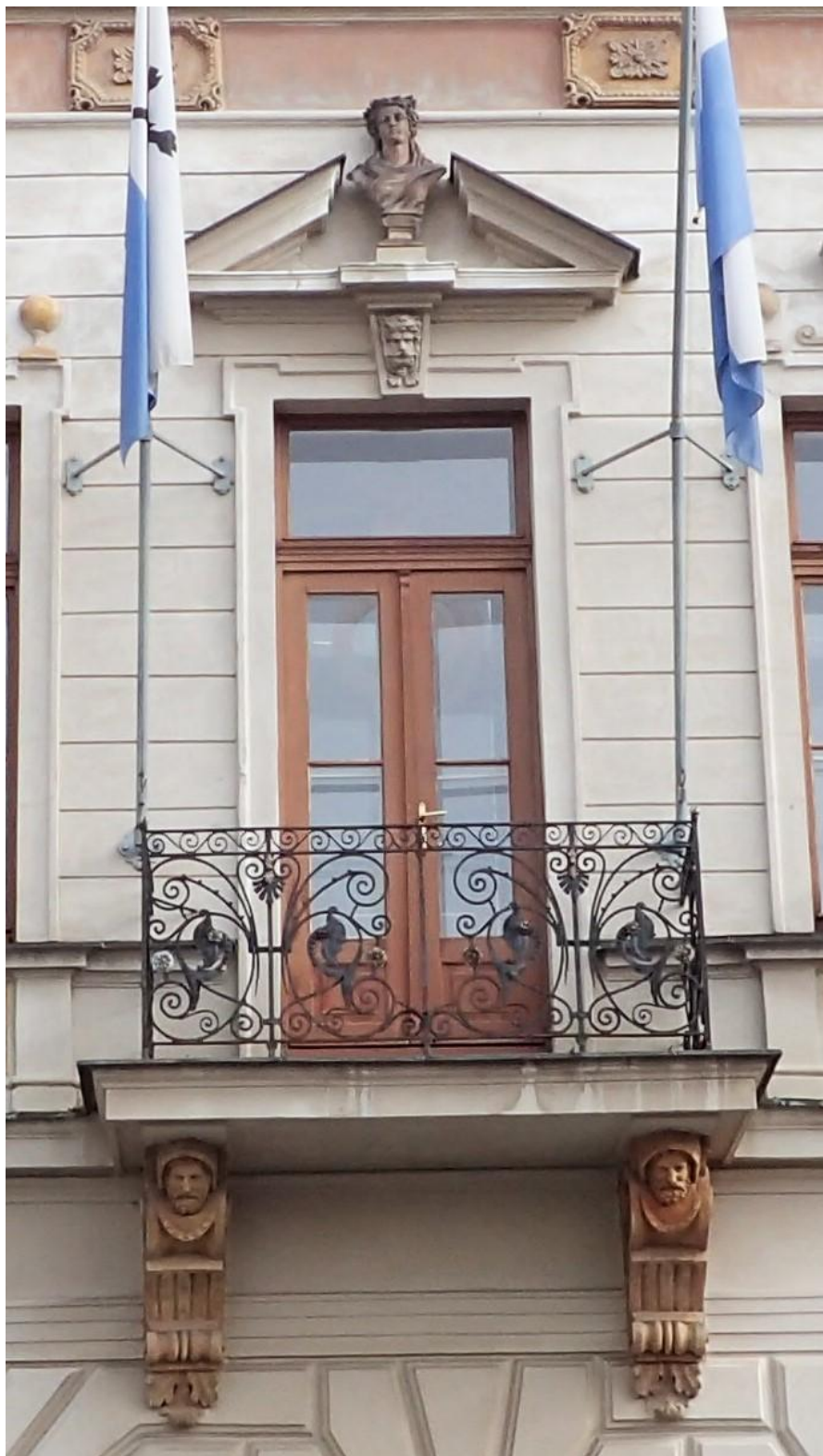
Obr. č. 5 Stav při průzkumu – dveře 2. NP – vnější strana – celkový pohled Celkový pohled na dveře z náměstí v 2. NP. Konstruktivně jsou dveře v pořádku, povrchová úprava je dožilá. Barevný krycí nátěr se hlavně ve spodní části uvolňuje a odpadá. Stav je podobný jako u oken v 1 np.
