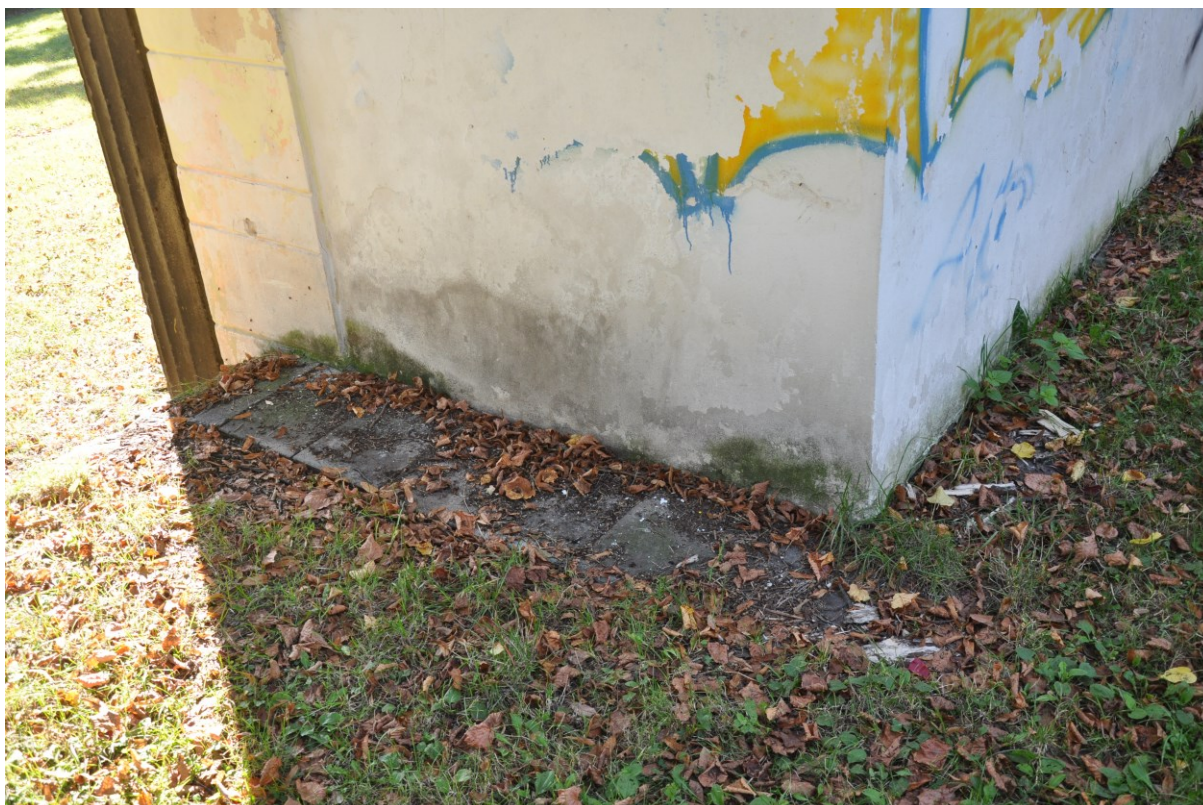
Obrázek 10 – Detail zavlhčených map zdiva, oprýskaná nejmladší barevná povrchová úprava, zanesený a zarostlý okapový chodník
