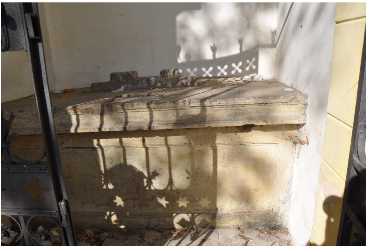
Obrázek 13 – Nečistotami zanesená kamenná římsa, místo po chybějícím prvku
