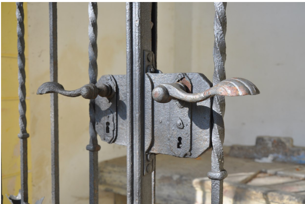
Obrázek 19 – Detail brány, na místech s absentující barvou vzniká povrchová koroze
