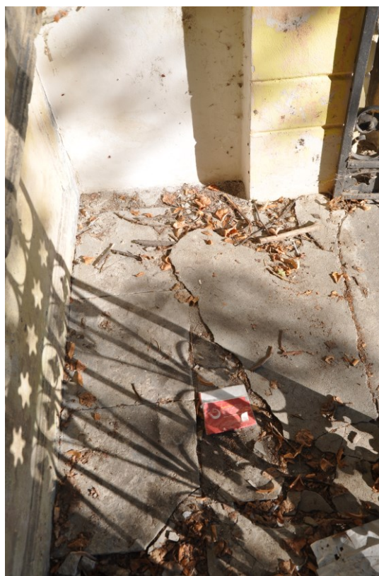
Obrázek 18 – Dlažba před kamennou menzou, z části poškozená a z části zalitá betonem
