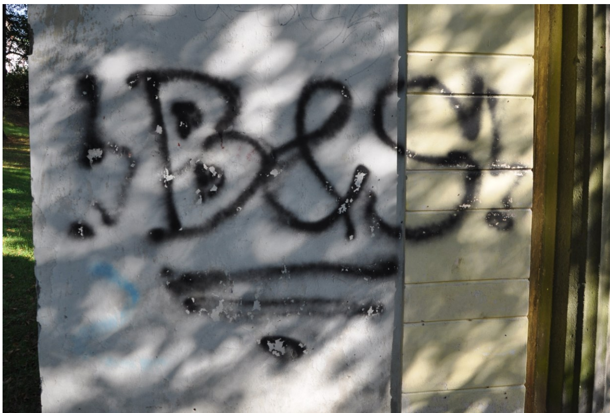
Obrázek 9 – Detail poškození, graffiti, oprýskaná nejmladší barevná povrchová úprava
