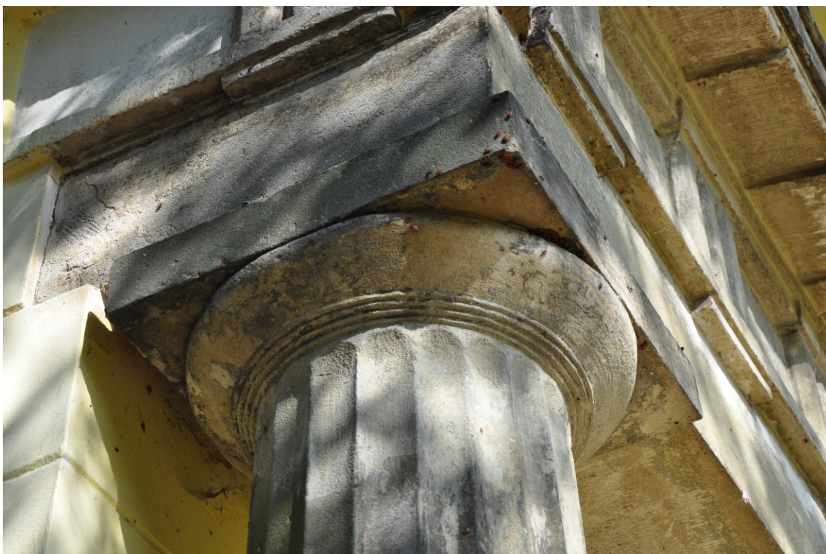
Obrázek 14 – Kamenné prvky s fragmenty barevných povrchových úprav zanesené nečistotami a biologickým napadením
