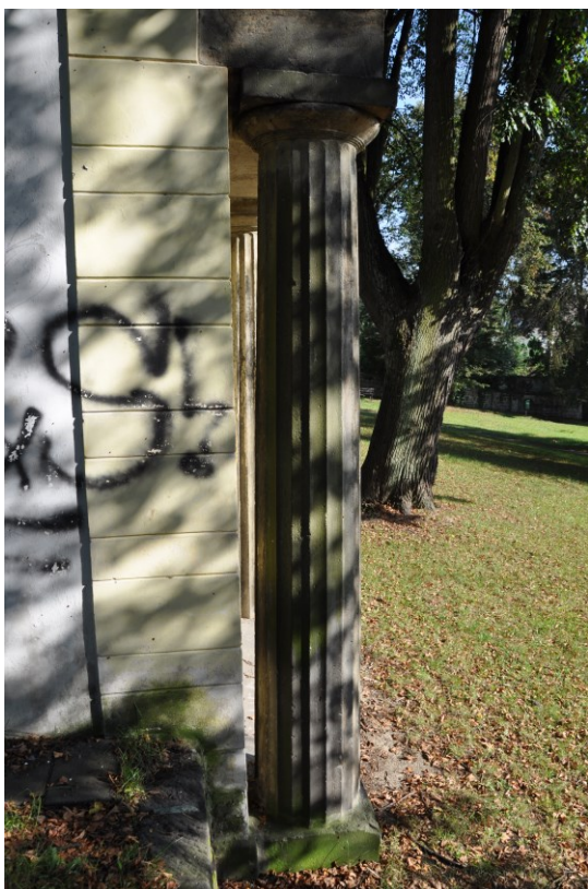
Obrázek 15 – Sloup pokrytý biologickým napadením
