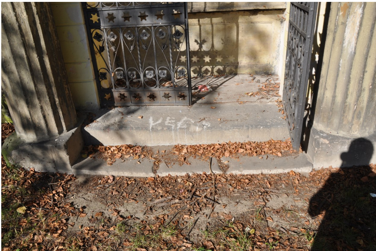
Obrázek 12 – Detail prasklého a propadlého schodišťového stupně
