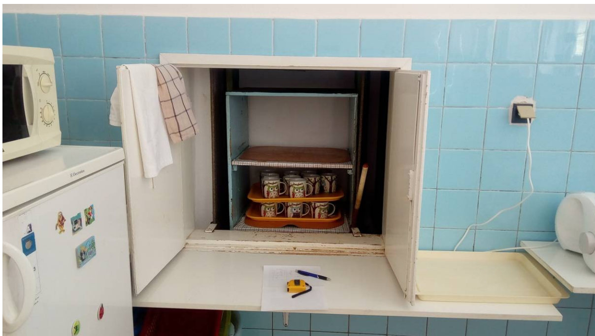
Stanice výtahu v 1. NP – levý výtah
