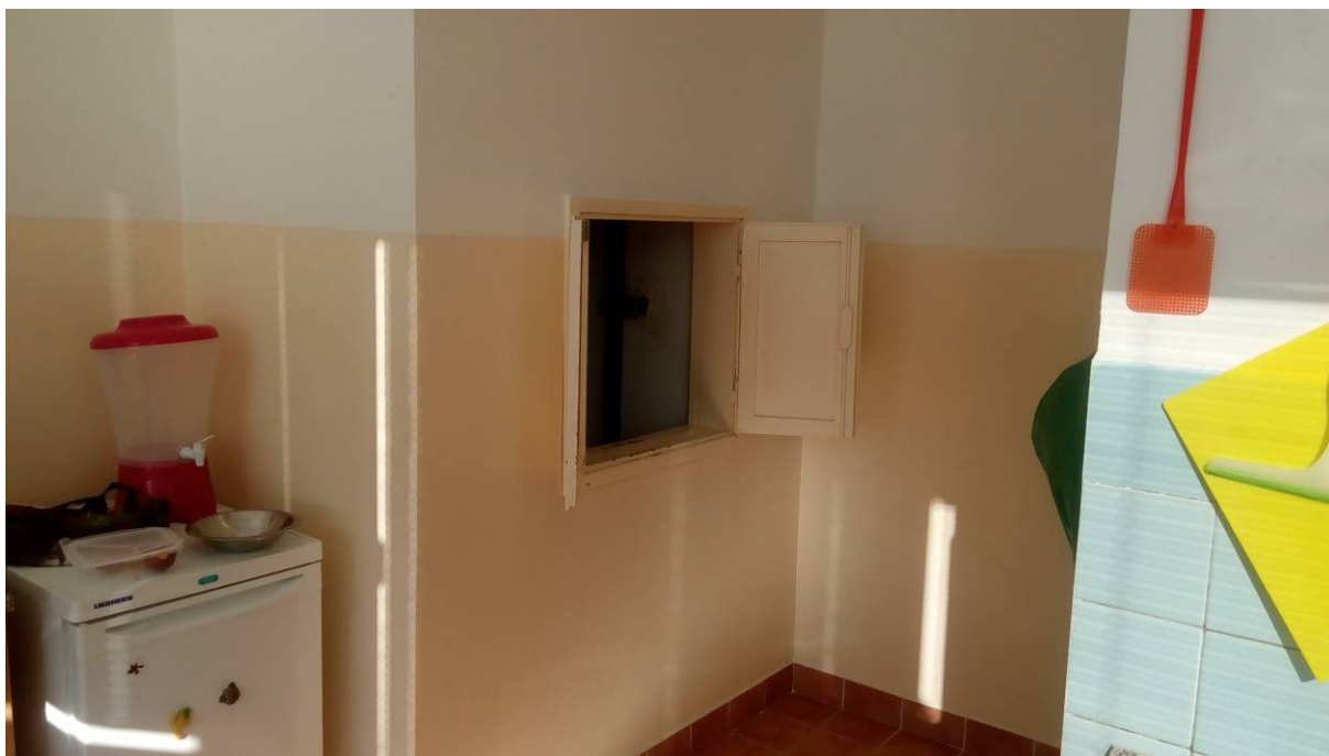
Stanice výtahu v 2. NP – levý výtah
