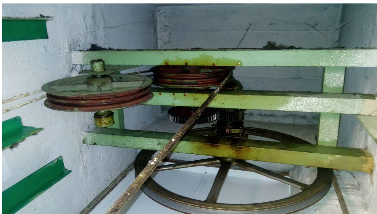
Výtahový stroj v 2. NP
