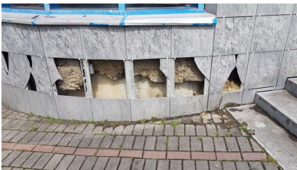
Obr. 12: Detail poškození fasády 1
