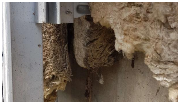
Obr. 13: Detail poškození fasády 2
