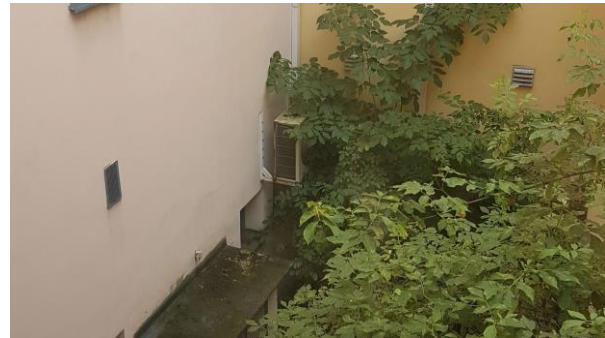
Obr. 21: venkovní část split jednotky
