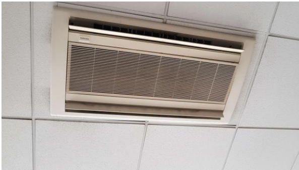
Obr. 20: vnitřní část split jednotky
