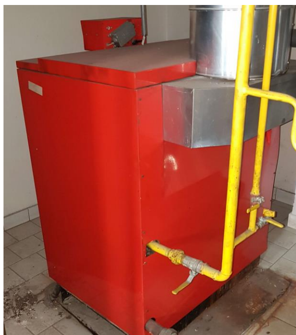
Obr. 17: Kotel na vytápění 2
