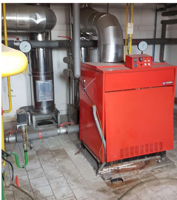
Obr. 16: Kotel na vytápění 1
