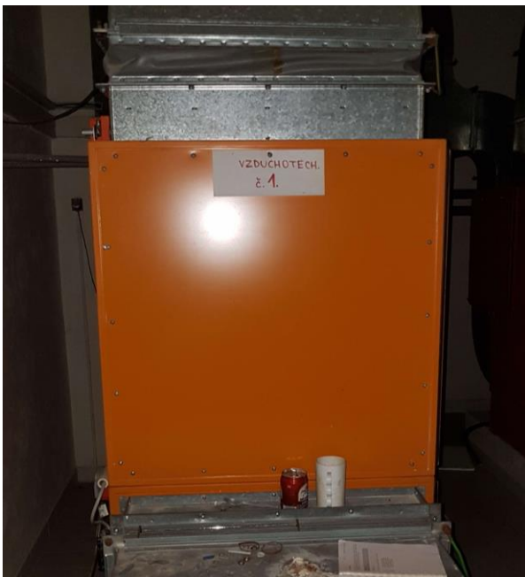
Obr. 22: vnitřní část split jednotky
