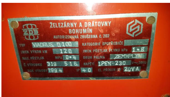
Obr. 18: Kotel na vytápění - štítek
